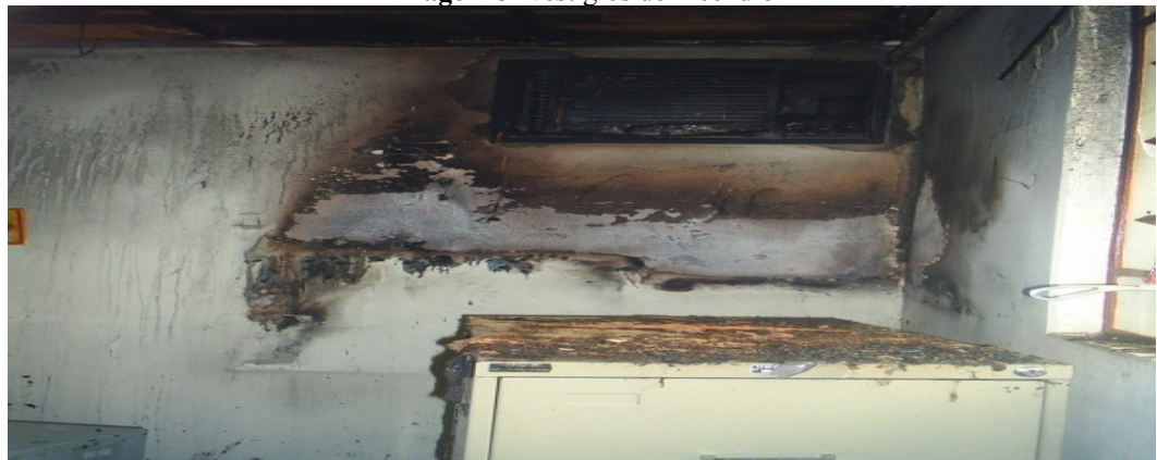
Imagem 3- vestígios do incêndio
